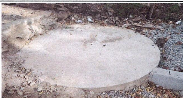
Foto 3: Mantenimiento a fosa séptica.
